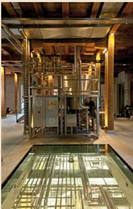
Die neue Anlage hat eine Kapazität von 30 hl/Sud
